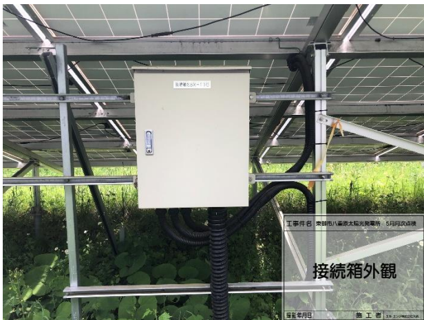
接続箱外観状態
