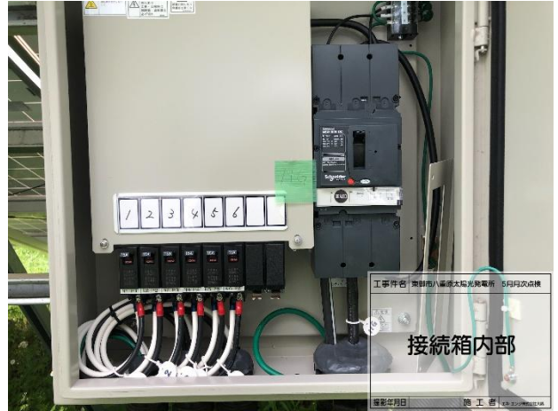
接続箱内部状況
