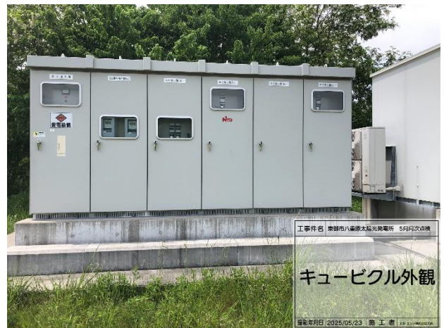
キュービクル外観写真
