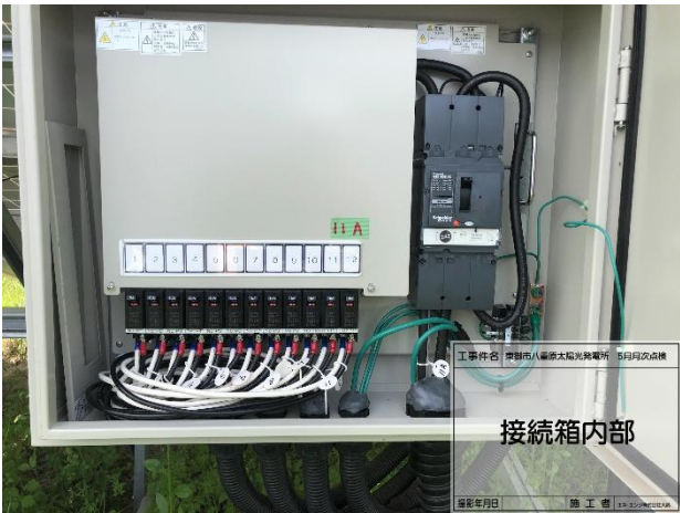
接続箱内部状況②
