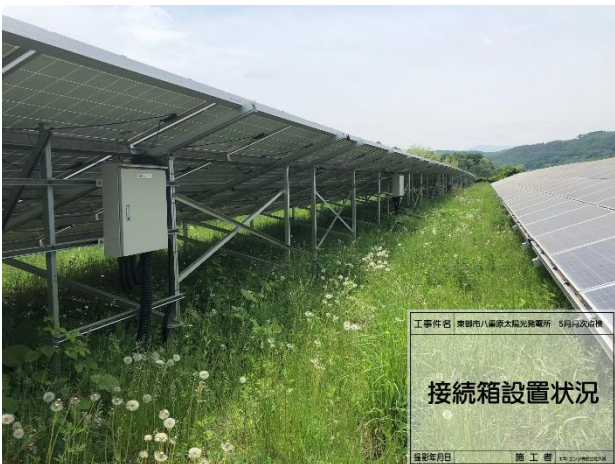
接続箱設置状況
