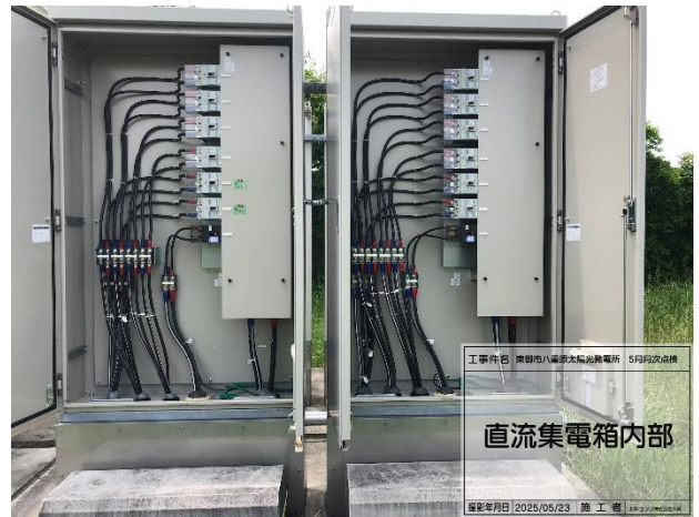
直流集電箱内部状態
