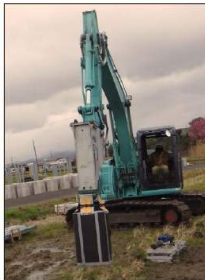
【防音カバー取付後機械】
