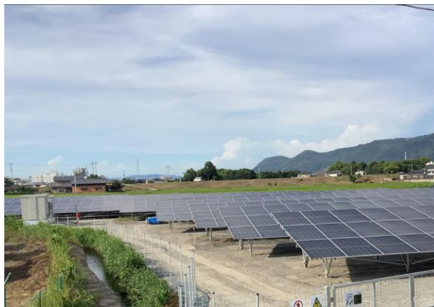
パネル（モジュール）
