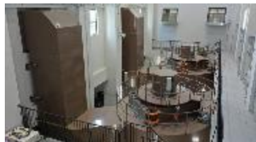
小水力発電所の設置
