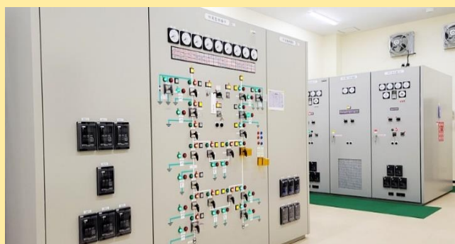
特高監視操作盤
