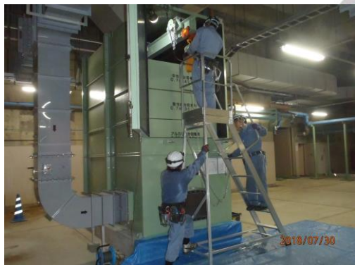
←汚泥棟に設置している脱臭設備
