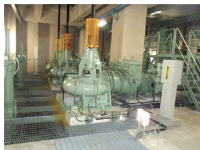
①汚水ポンプ
