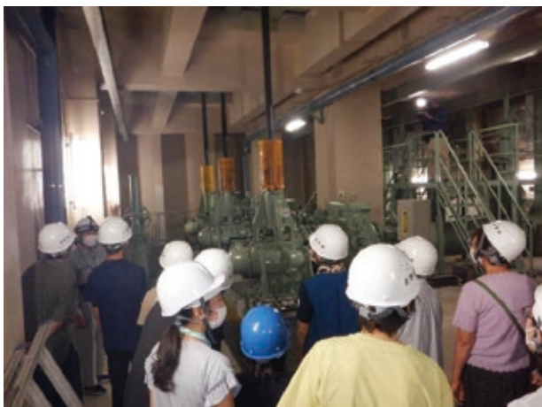
沈砂池ポンプ棟(主ポンプ)
