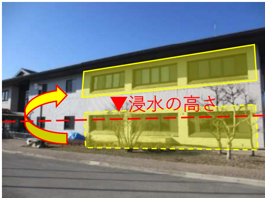
(管理棟電気室) ※1階から2階へ移設
