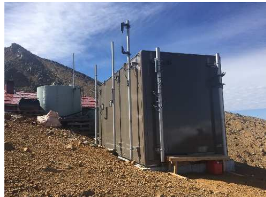
＜ 御嶽山に整備した携帯電話基地局 ＞
