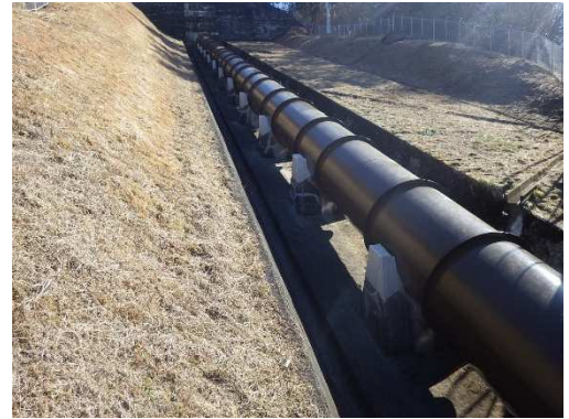
(県営小洪第2発電所)
