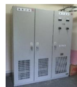
防災行政無線地上系電源設備
