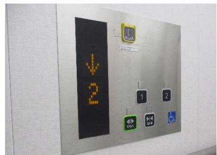
大ホールエレベーター内
