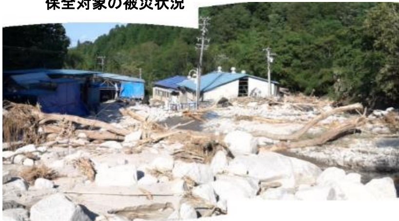
保全対象の被災状況
