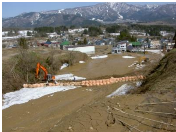
保全対象被災状況
