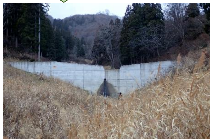
竣工から5年後の状況 （平成30年12月撮影）
