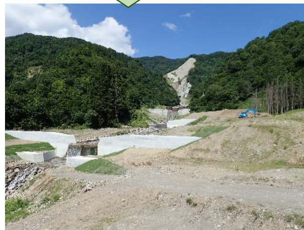
災害発生から 8年後の状況 （令和30年撮影）
