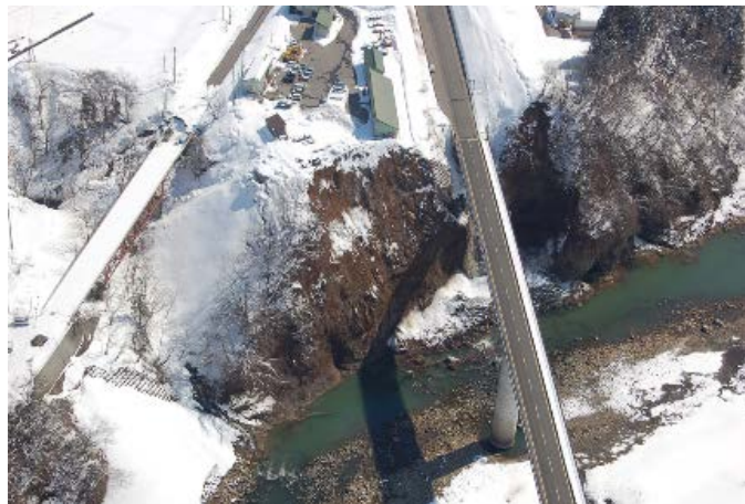
災害発生時の状況（平成23年3月撮影）
