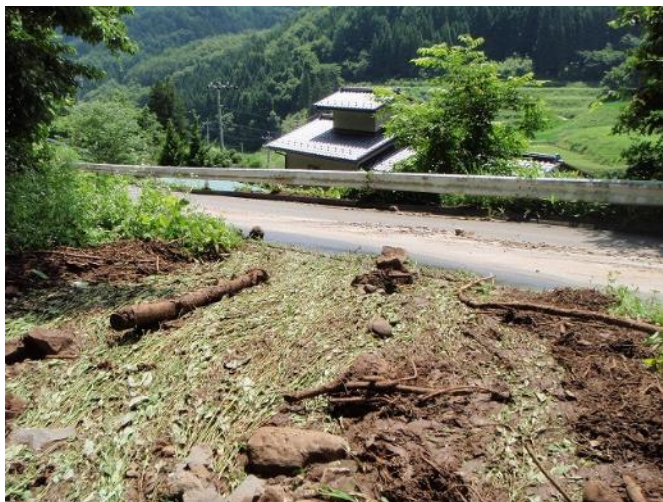
保全対象の被災状況
