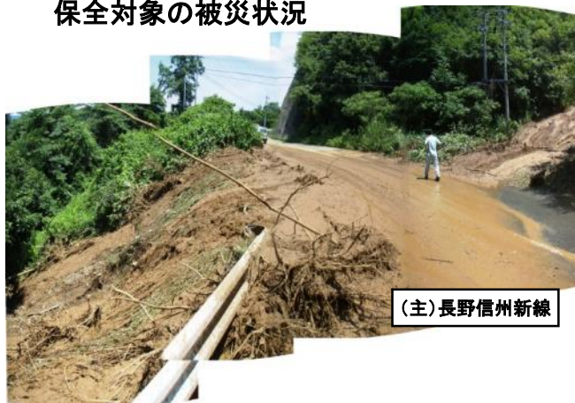
保全対象の被災状況
