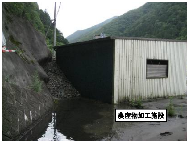
保全対象の被災状況
