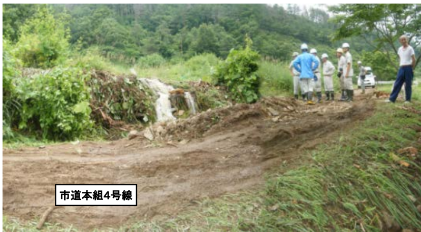
保全対象の被災状況
