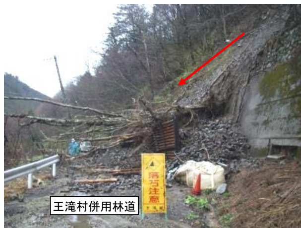
保全対象の被災状況
