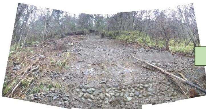
災害発生時の状況（平成22年4月撮影）
