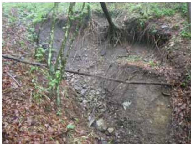
① 侵食・崩壊地の状況
