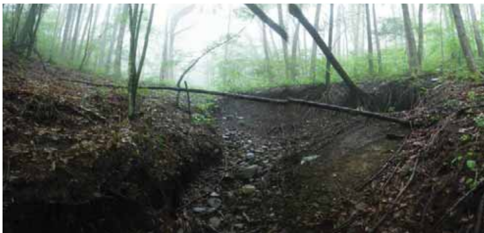
⑤ 施工前の状況（湧水により侵食・崩壊が進行）
