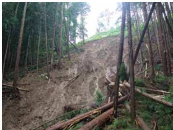
② 崩壊地の状況
