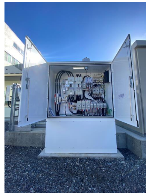
切替盤：鶴田電機製
