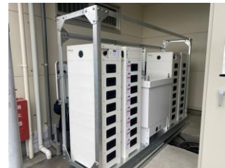
● 蓄電池 : SOLAX製3.68kWh×32台 ● トランス : 鶴田電機製
