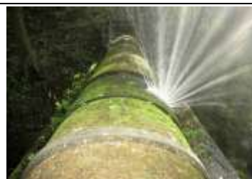
【老朽化が進行し漏水が著しい農業用水路】
