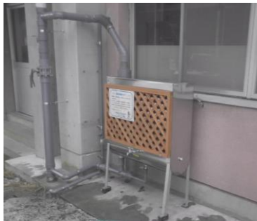
雨水貯留タンク （長野商業高校）
