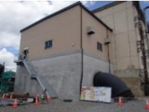
浸水を防止するため機場を高所化
