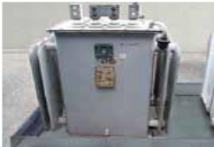
トランス（変圧器）
