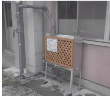
雨水貯留タンク （長野商業高校）
