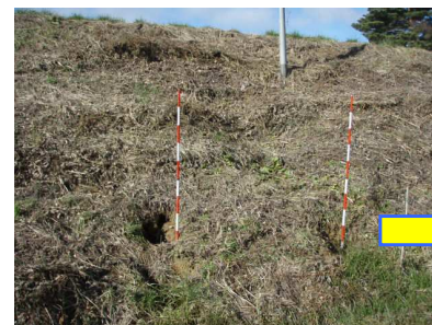
堤体を開いた漏水孔
