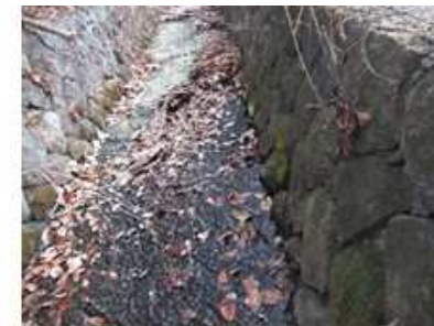
老朽化により間隙が背面へ貫通した洪水吐水路
