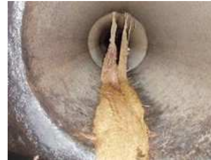
接合部から木の根が進入している状況
