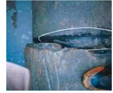
漏水箇所 接合部の離脱状況 HPφ900
