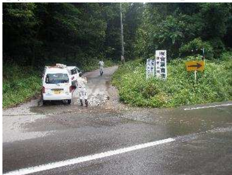
公共施設への漏水
