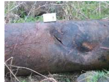
管の腐食状況
