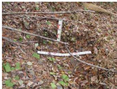
漏水による地山が洗堀
