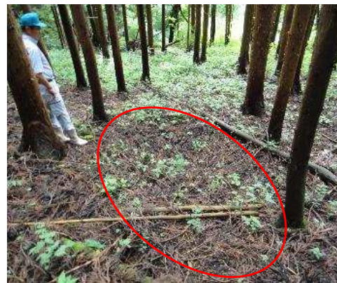
漏水による管頂の地山が陥没
