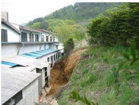
漏水による人家への土砂崩落
