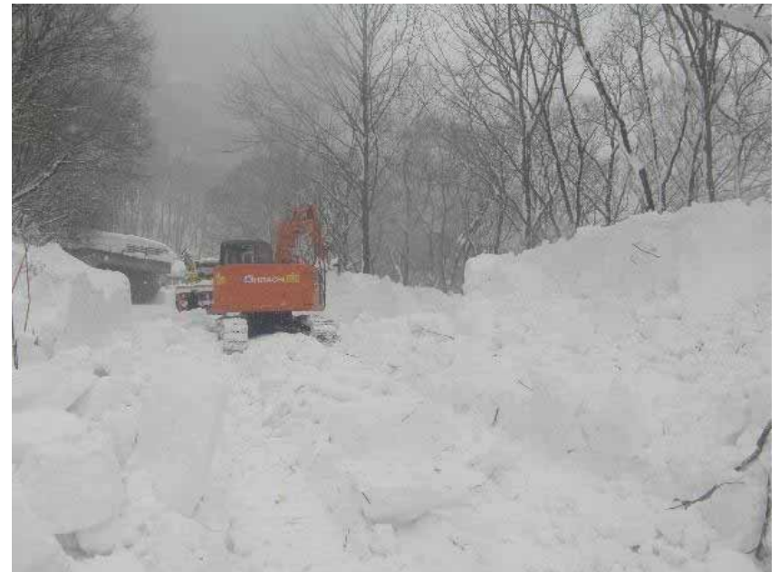
雪崩発生直後の除雪実施状況（平成20年3月撮影） P8-8
