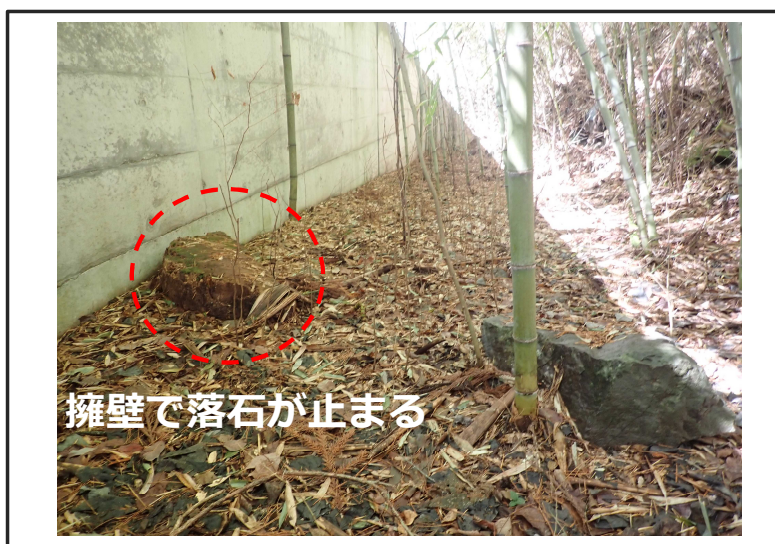
落石捕捉状況
