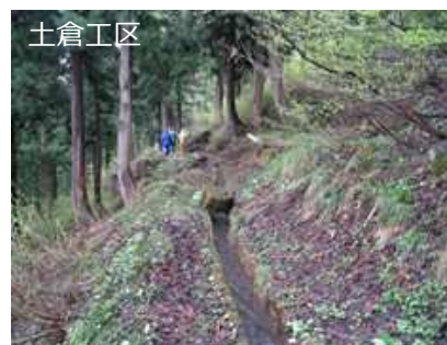
雪解けにより巨石が崩落し水路を破損
