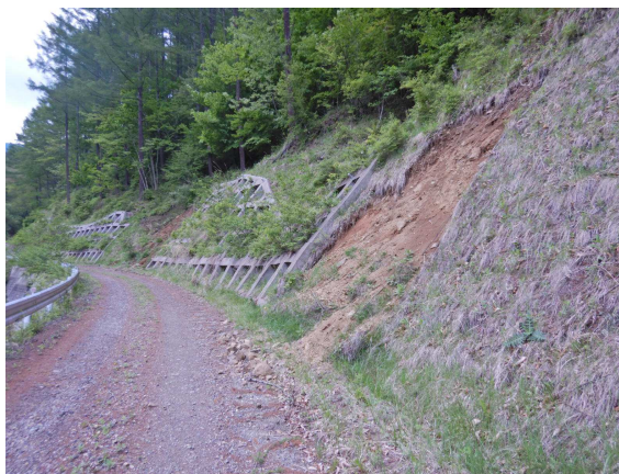
管理用道路 法面崩壊状況 経過観察とする
