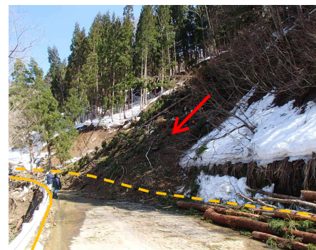
(林道大川線の被災状況)
