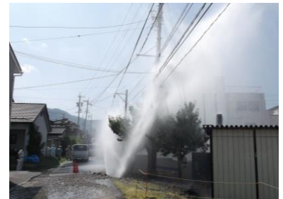
老朽管破損による漏水
