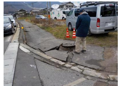
神城断層地震時の被害
