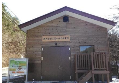
陣内森林公園発電所
