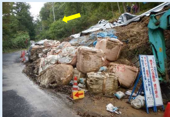
令和元年台風19号による市道への土砂の押し出し
