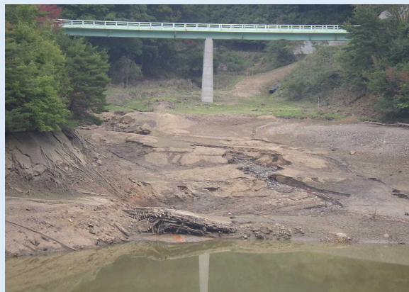
土砂堆積状況(R2.10月)
