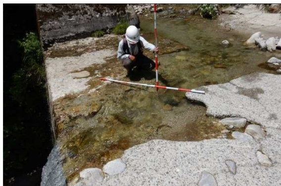
砂防堰堤の天端摩耗（阿南町 門原川）
