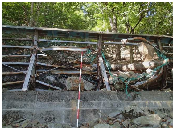
落石防護工の落石被災状況（大鹿村 落合北）
