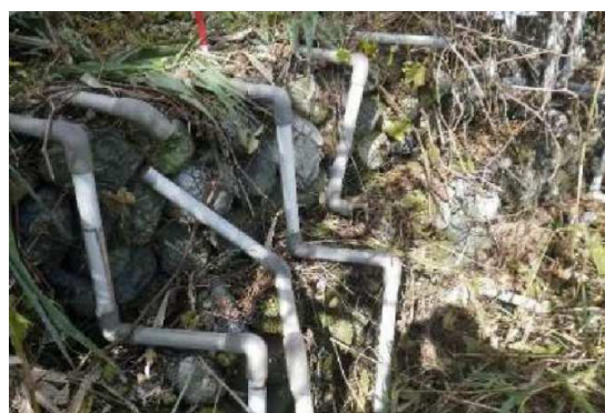
横ボリング工の導水管の損傷（小谷村 葛草連）
