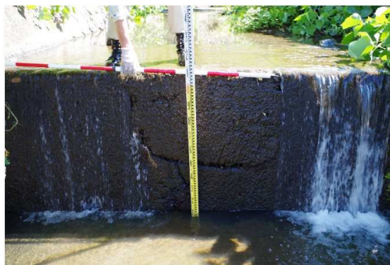
床固工のひび割れ（上田市 湯川）
