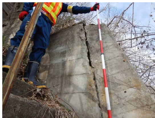
待受擁壁工の亀裂状況（長野市 狐池）
