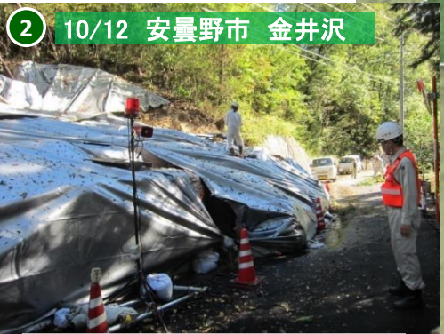
【被害状況】人的被害なし
