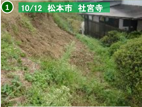
【被害状況】人的被害なし
