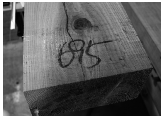
写真 5 平角材乾燥後材面割れ
