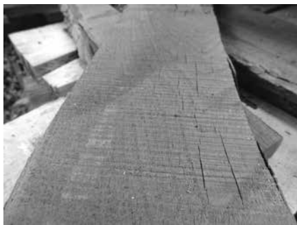
写真-23 表面に発生した割れ
