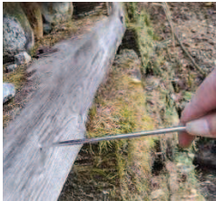
写真-2 同本体部のドライバー刺突状況
