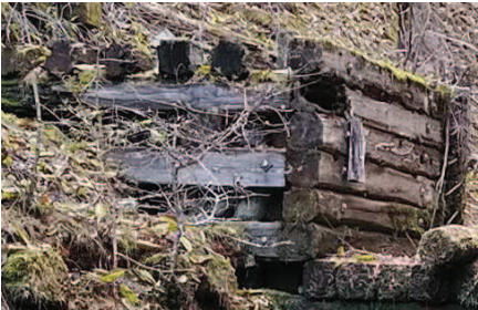
写真-1 松本市カワグルミの施設袖部の劣化状況
