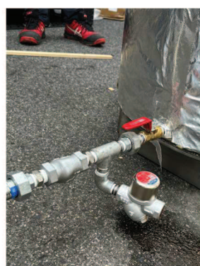
写真-2 水蒸気取込状況と減圧弁
