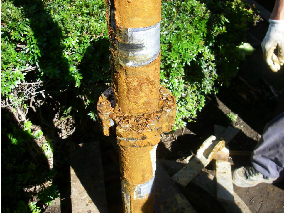
写真1 揚水管に付着する錆やスケール（抜管時）
