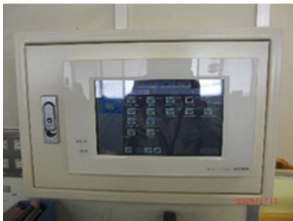
エアコン集中コントローラー
