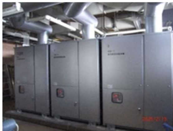
冷温水発生機(3機)
