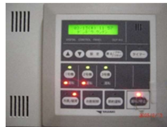
冷温水発生機コントロールパネル
