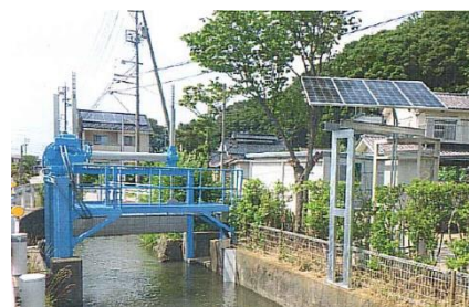
【自動化した会地排水門（坂城町）】
