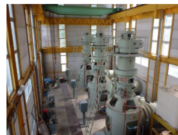
【飯山市 木島地区 木島第一排水機場】
