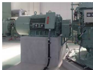
浸水対策を強化 高所（コンクリート土台）に 排水ポンプの駆動装置を 設置
