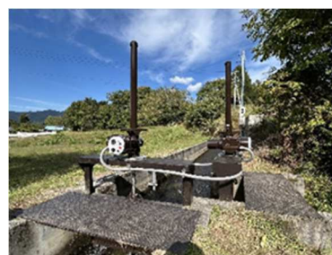
【自動化した角名樋場分水工（茅野市）】
