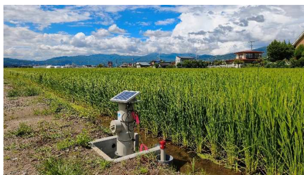
【自動給水栓 設置状況】
